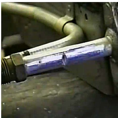
Нарушена герметичность трубки кондиционера или радиатора
